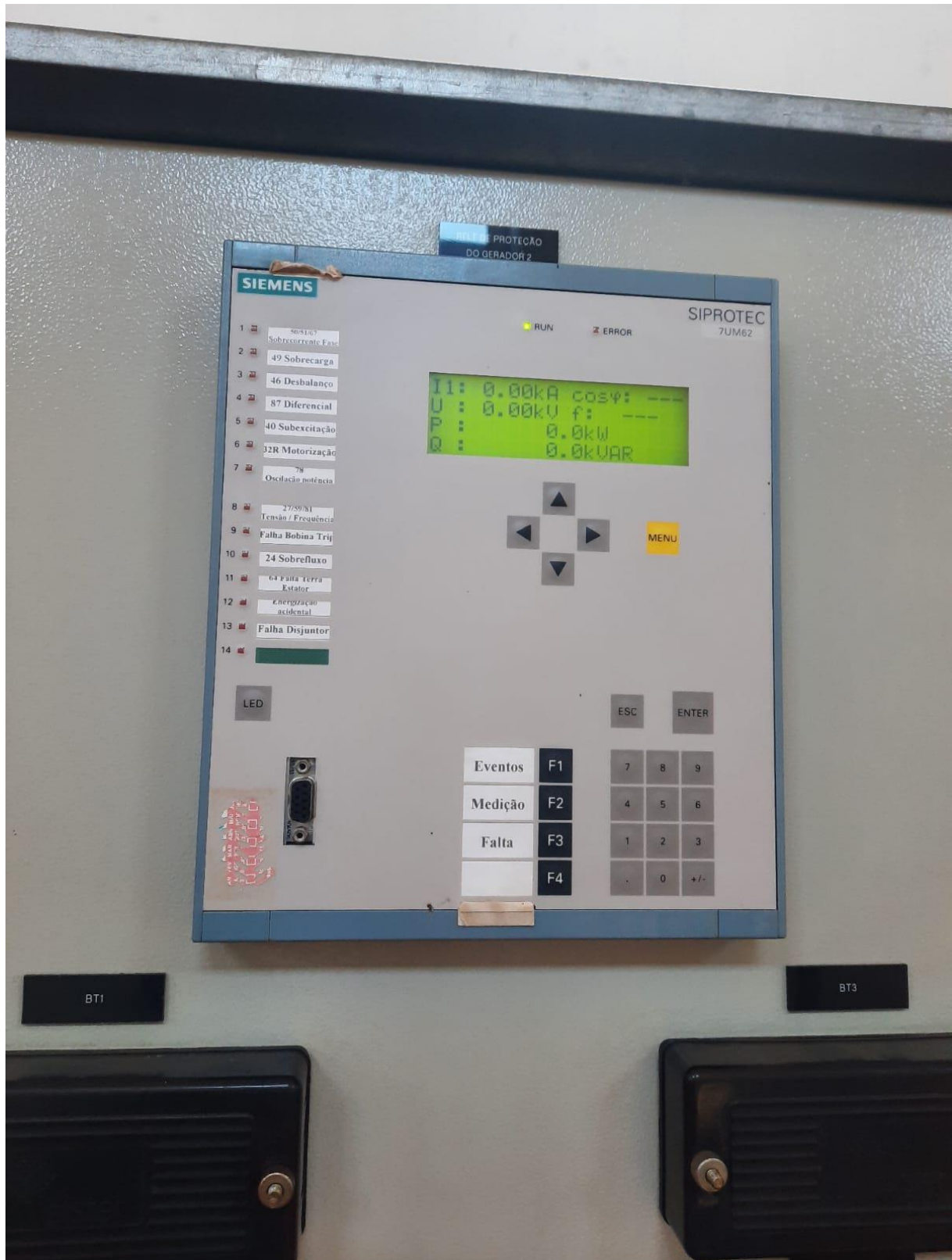
Figura 40 - Relé de proteção analisado 7UM62 do gerador G2
