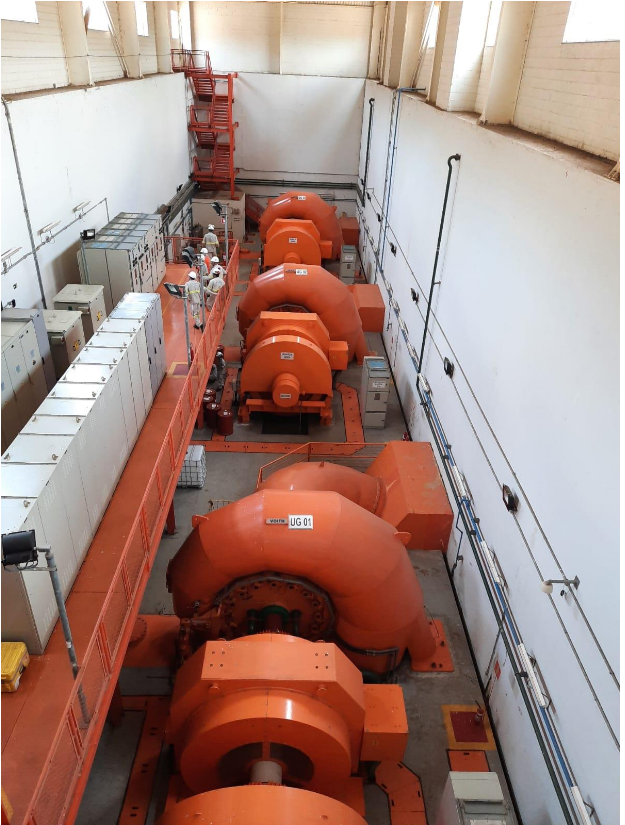
Figura 39 - Conjunto de unidades geradoras
