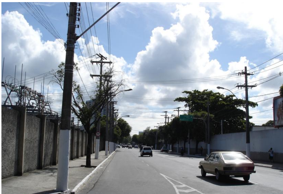
Figura 12 - Saída dos alimentadores aéreos da SD Praia
