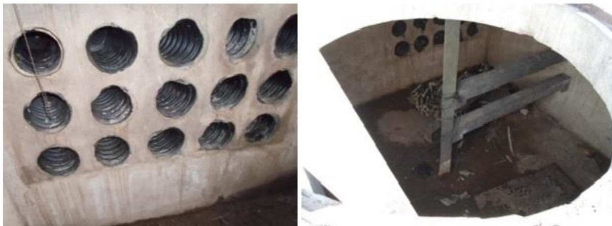
Figura 5 - Caixa de passagem de uma rede subterrânea de distribuição
