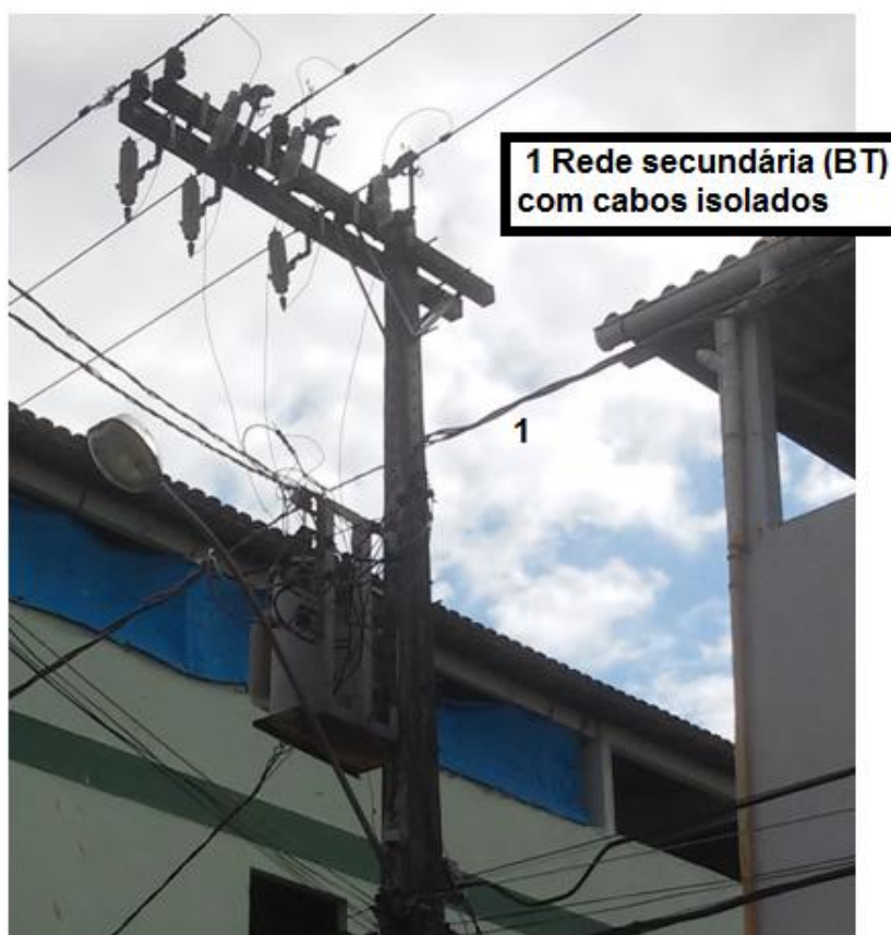
Figura 4 - Rede aérea protegida (baixa tensão)
